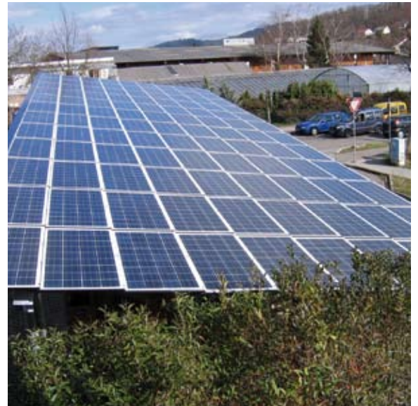
»Intelligente Energielösung in Freiburg: Der Carport mit 108 Solarmodulen des Typs FL130T-1A von Kyocera spart ca. 8,2 Tonnen CO 2 pro Jahr ein.
